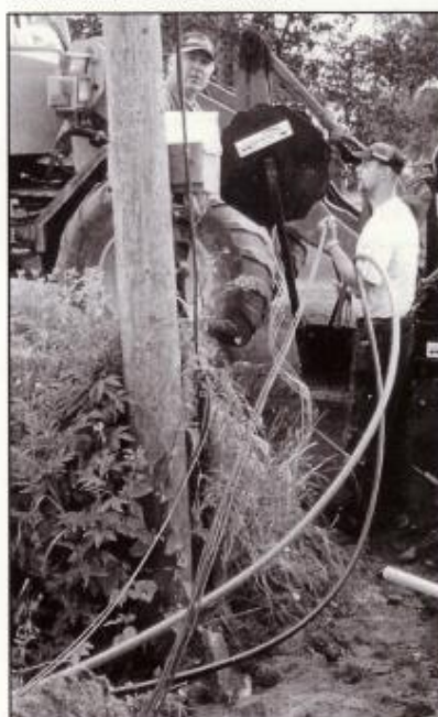
Ibland var det många kablar att hålla reda på...
